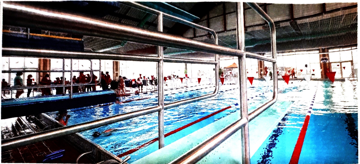
Im Haunstetter Hallenbad muss die Decke mit einem Netz abgedeckt werden, weil Teile herunterfallen könnten.
